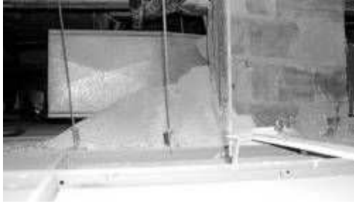
Grava desprendida del pilar que ha sufrido una grieta. Foto: J.A.R.
